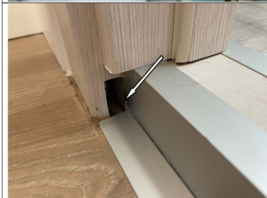
Фото №45. Дефект прилегания наличника в ванной комнате.
