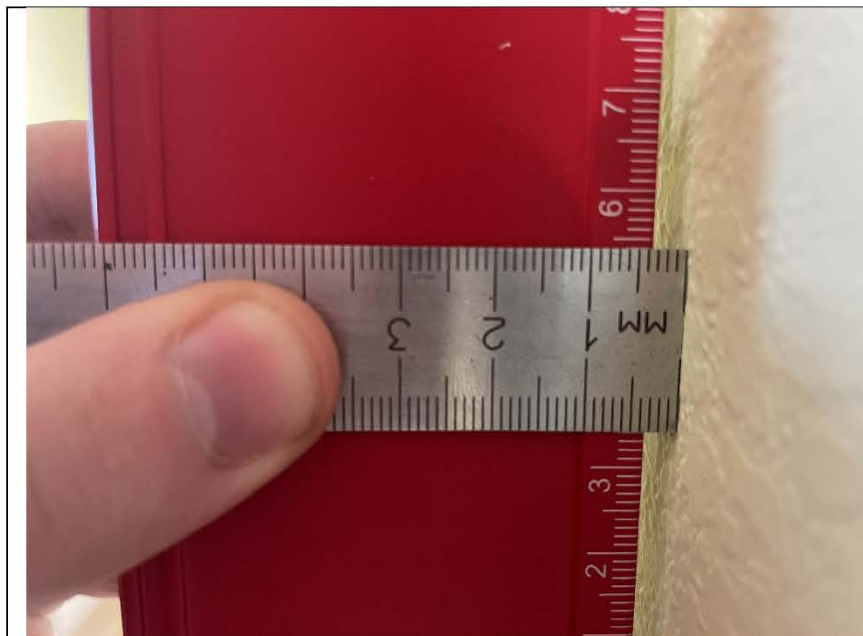
Фото №10. Измерение уровня стен в коридоре в квартире.
