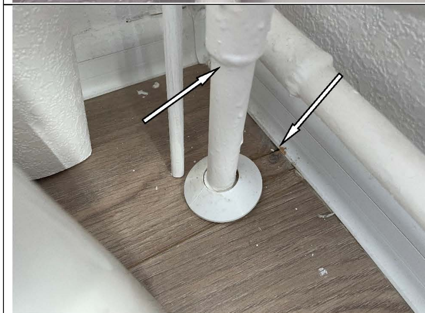
Фото №18. Трубы отопления в детской окрашены с дефектами. Заделка труб отопления в напольном покрытии.
