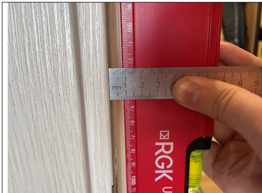
Фото №43. Отклонение дверного блока в спальне.
