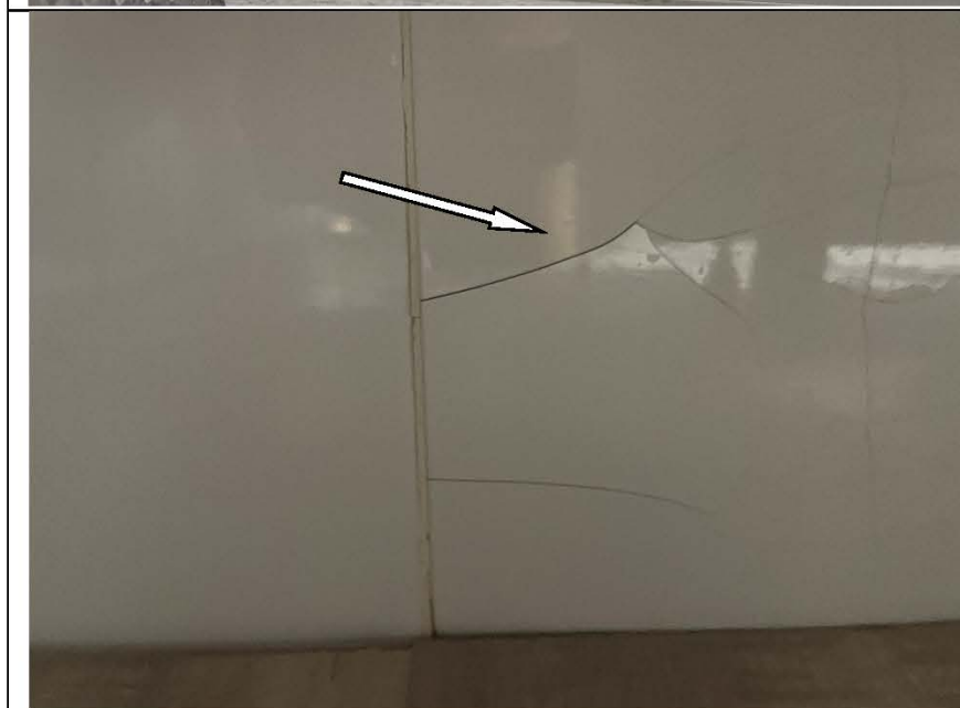
Фото №48. Трещина настенной керамической плитки в ванной комнате.
