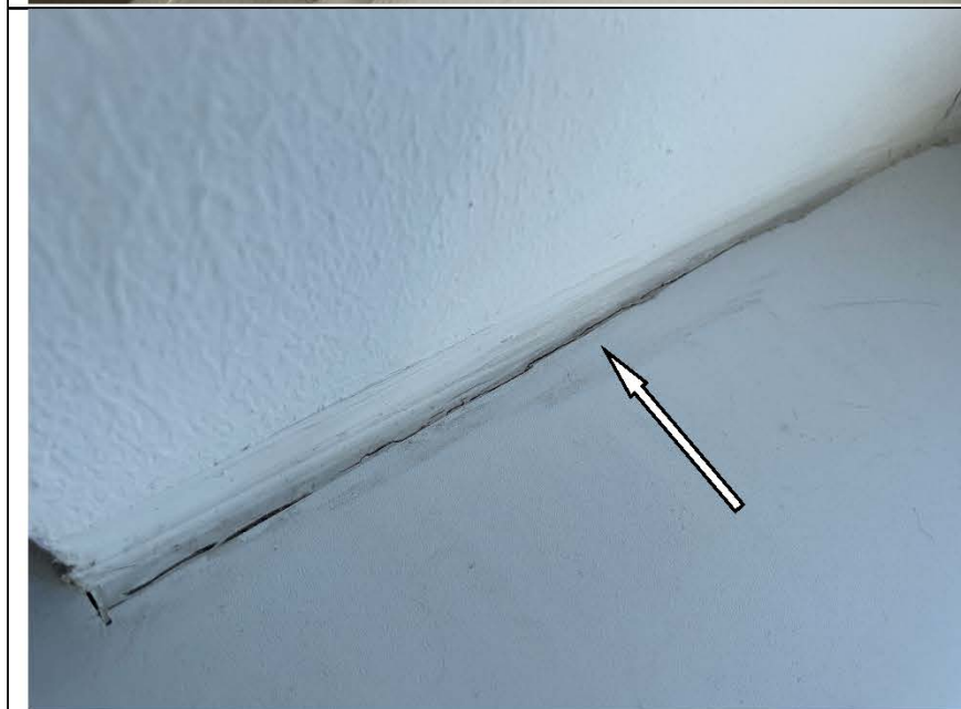
Фото №42. Дефект монтажа подоконника в кухне.
