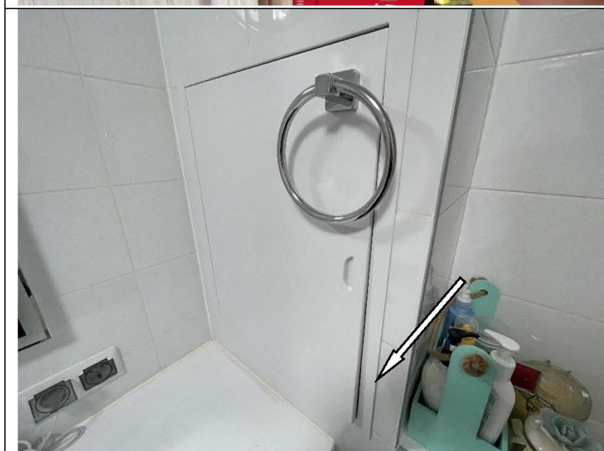
Фото №44. Сантехнический люк в ванной изогнут.
