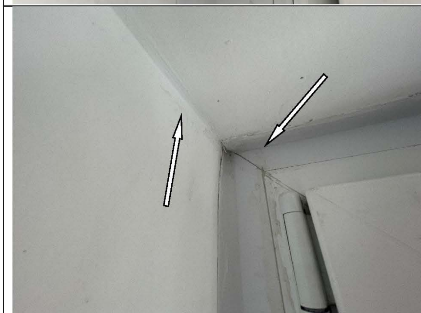
Фото №27. Дефект монтажа оконного блока в детской. Дефект окрашивания откосов.
