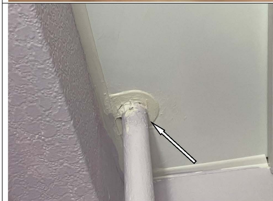
Фото №17. Трубы отопления в кухне окрашены с дефектами. Дефект натяжного потолка.
