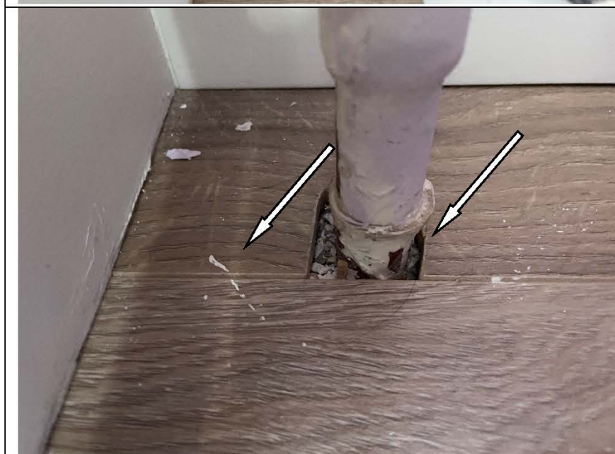
Фото №20. Заделка труб отопления в напольном покрытии в кухне. Загрязнение ламината.
