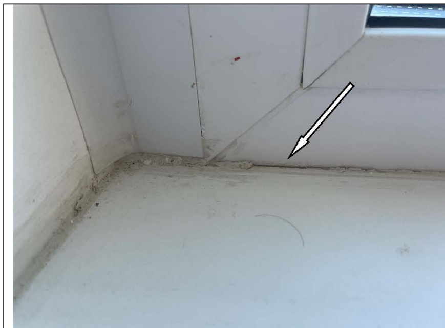
Фото №40. Дефект монтажа подоконника в спальне.
