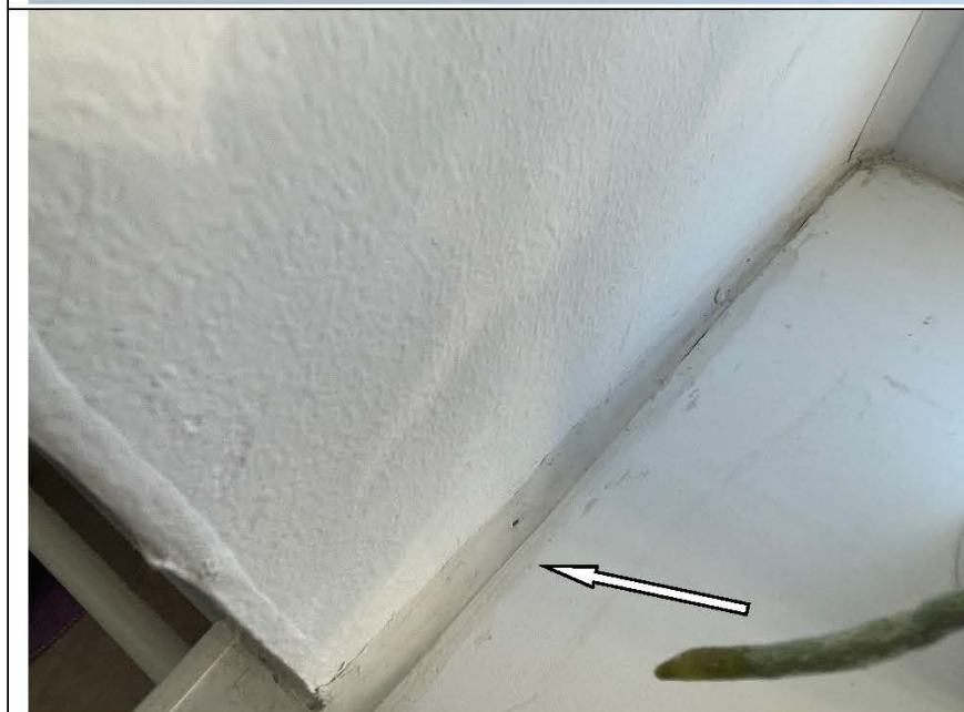
Фото №41. Дефект монтажа подоконника в детской.
