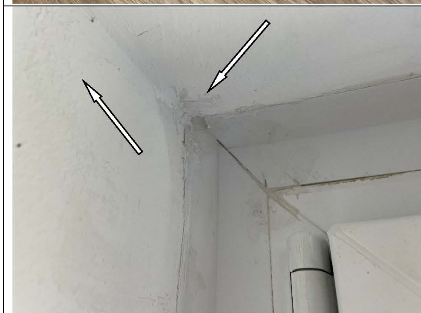
Фото №26. Дефект монтажа оконного блока в спальне. Дефект окрашивания откосов.
