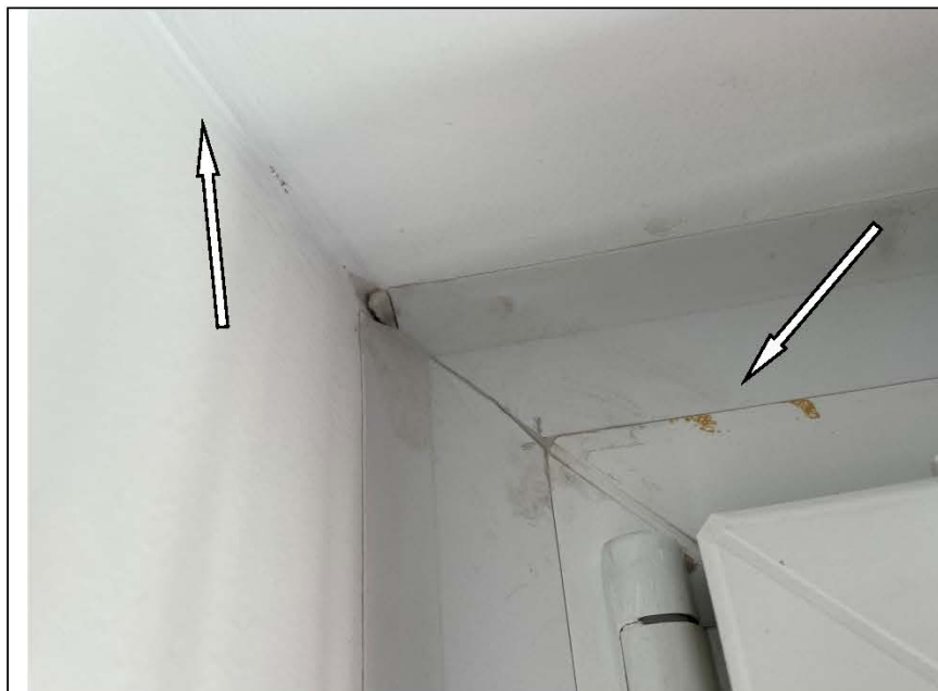
Фото №28. Дефект монтажа оконного блока в кухне. Дефект окрашивания откосов.
